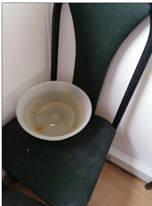
Rysunek 4.135 Cieknący dach w remizie. Źródło: archiwum OSP Sobin.
