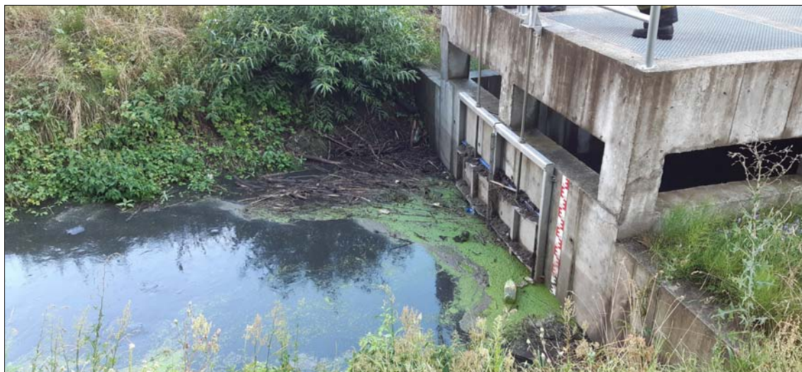
Rysunek 4.104 Przegląd urządzeń wodnych zabezpieczających wieś Sobin przed zalaniem. Źródło: archiwum OSP Sobin.
