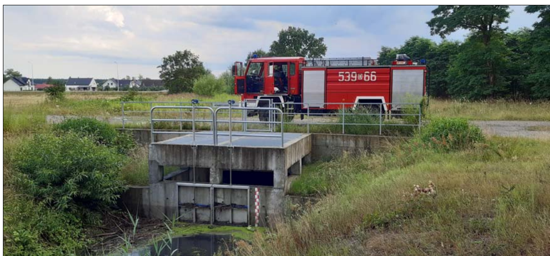
Rysunek 4.105 Przegląd urządzeń wodnych zabezpieczających wieś Sobin przed zalaniem. Źródło: archiwum OSP Sobin.
