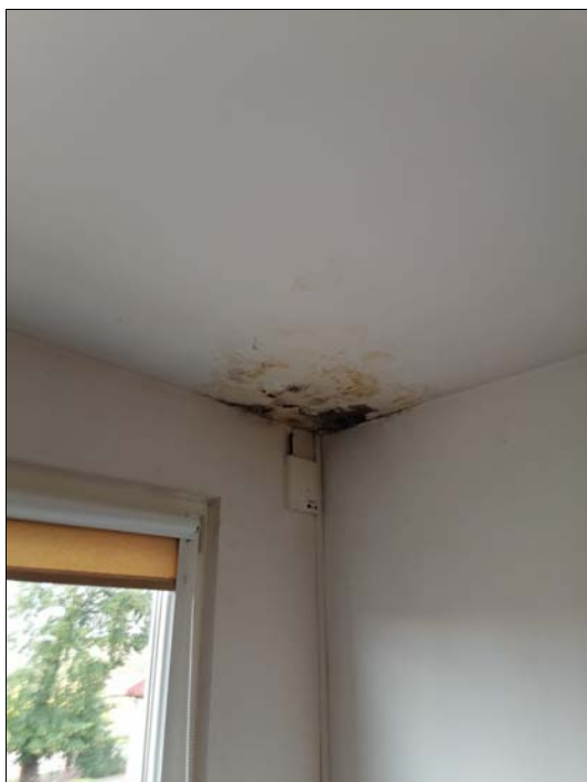
Rysunek 4.132 Ciekący dach w remizie. Źródło: archiwum OSP Sobin.
