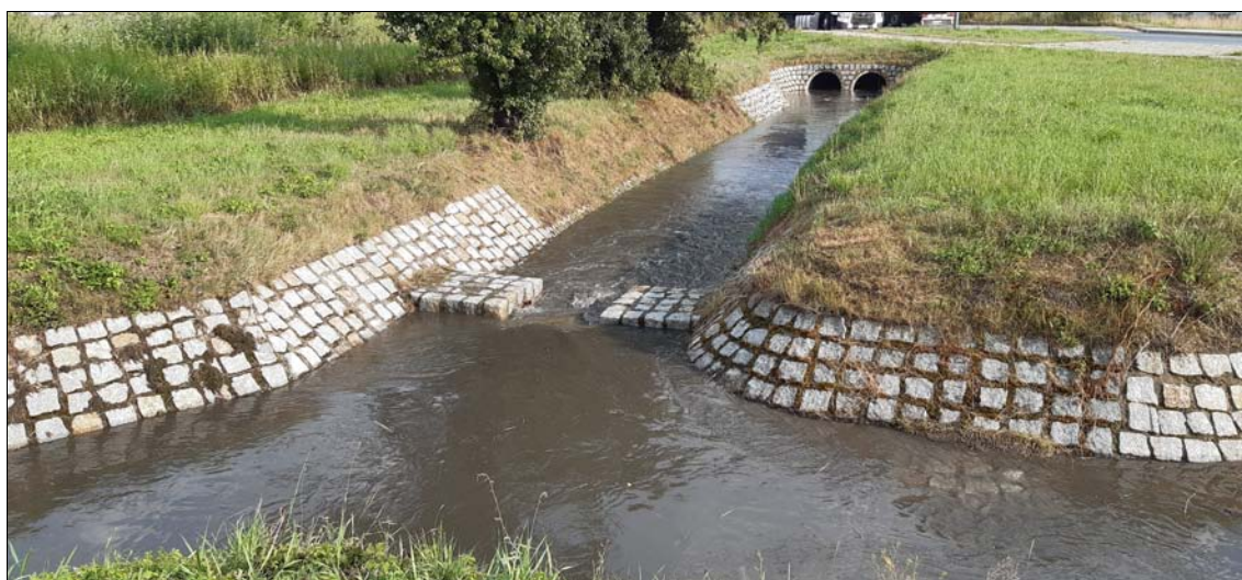
Rysunek 4.102 Przegląd urządzeń wodnych zabezpieczających wieś Sobin przed zalaniem. Źródło: archiwum OSP Sobin.
