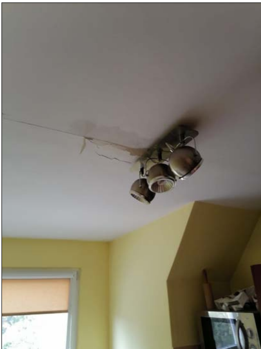
Rysunek 4.133 Cieknący dach w remizie. Źródło: archiwum OSP Sobin.
